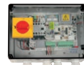
Coffret de commande CODE : CP01
